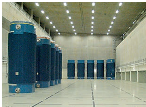
Kuva 3-15. Käytetyn polttoaineen kuivavälivarastointitila (E.ON 2008).
