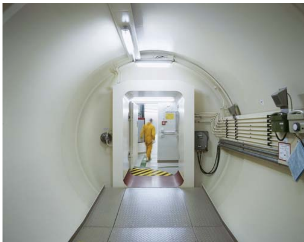
Skyddsbyggnaden runt reaktorn har en luftsluss genom vilken personalen går in.
