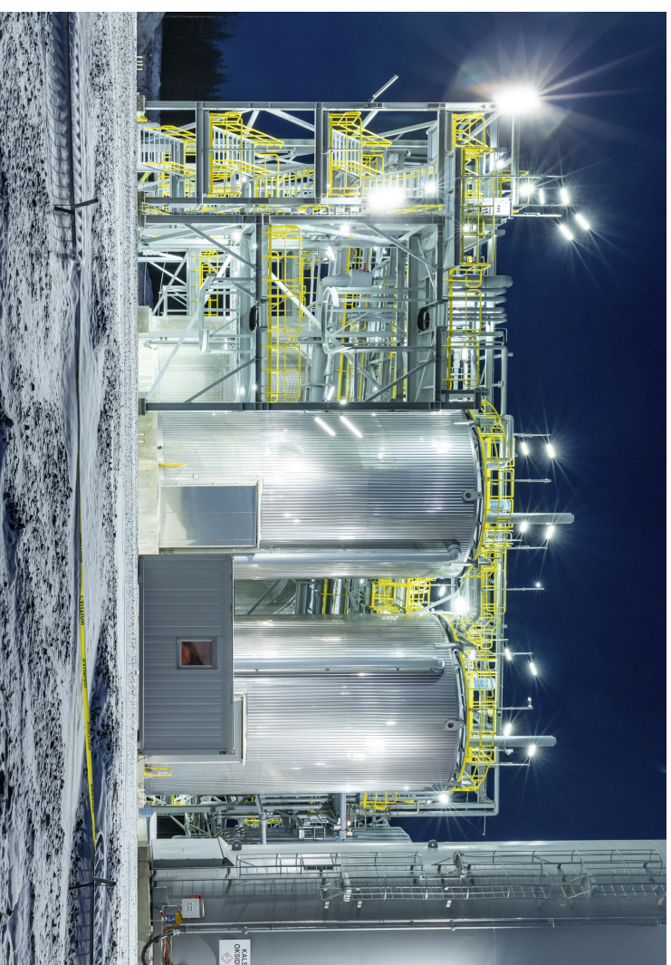
Vesienkäsittelylaitos Agnico Eagle Finland Oy:n kaivoksella Kittilässä
