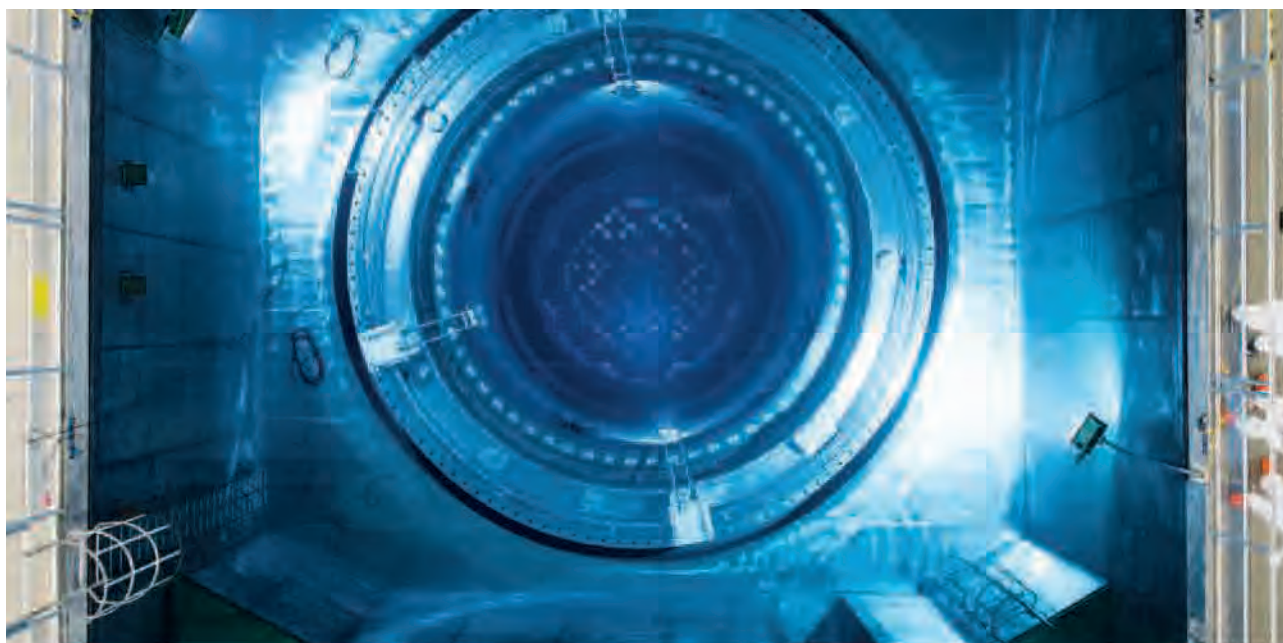
Reaktoripaineastia ylhäältä kuvattuna. Paineastian läpässä näkyvät kannen pulttien reiät, jotka on suojattu tulpilla. Kantta ympäröi suojarakennuksen tiiviste, ja kaikkein ulommaisena on suojarakennuksen kupolin kiinnityslappi.
